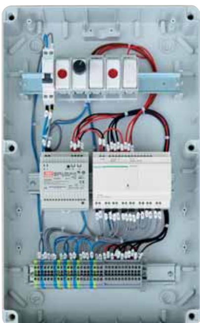
Esempio di Plc cablato Exemple de Plc câblé
